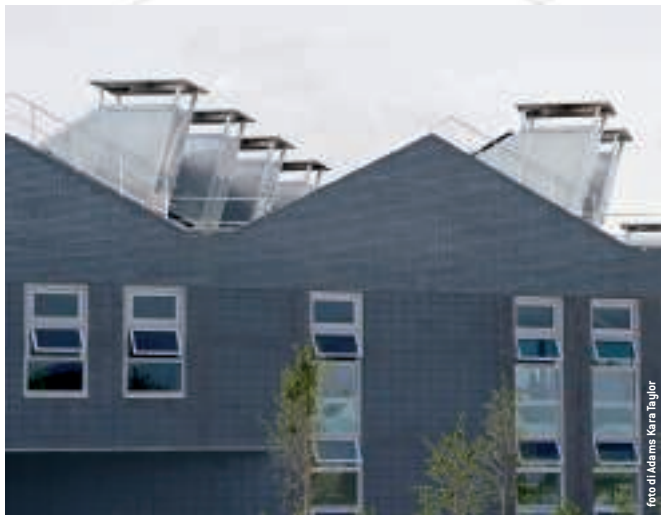
Vista degli snouts di ventilazione in struttura metallica leggera
